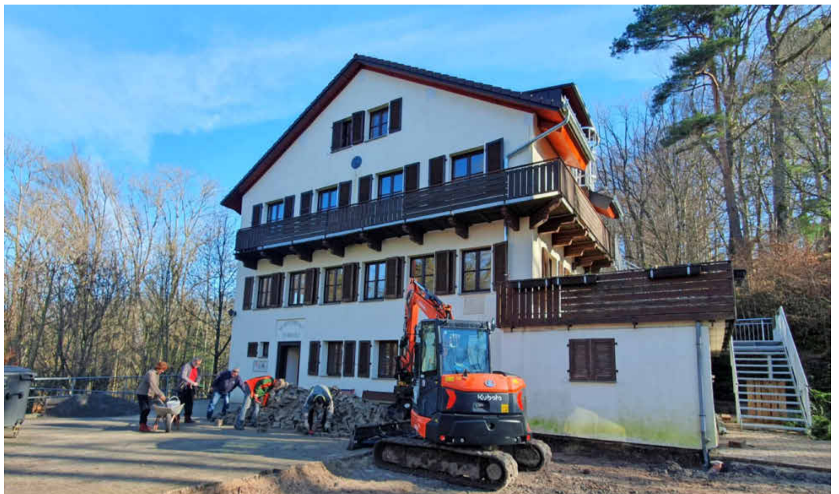
Das Naturfreundehaus Steinknickle läuft unter neuer Pacht. Die Bauarbeiten – rechts sind etwa die Feuertreppen im Bild zu sehen – sind nahezu abgeschlossen.
