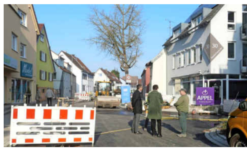
Bürgermeister Alexander Krüger, Bauamtsleiterin Annika Gärtner und Planer Volker Martin informieren sich bei Frank Hillgardt über den Baufortschritt. Foto: Harald Schmidt
